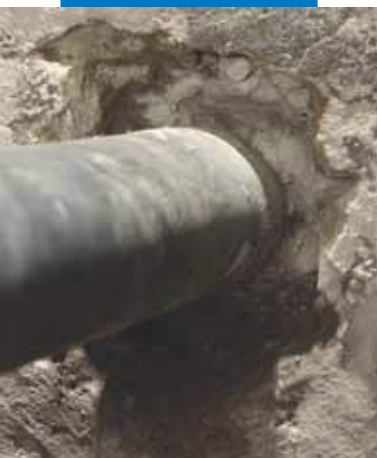
Lokální odbourání v okolí potrubí.
